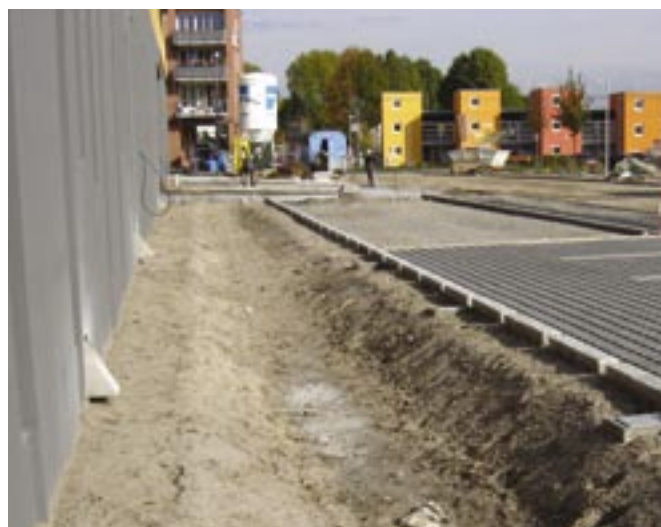
Obr. 40: Celoplošný odvod přes okraj komunikace do dosud nezatravněného vsakovacího příkopu (vsakovací rýhy)
