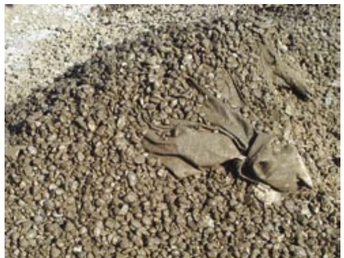
Obr. 65: Vsakování v tomto případě už bohužel není možné: nečistotami zanesená, nepropustná geotextilie ve vsakovací rýze po několika málo letech používání.
