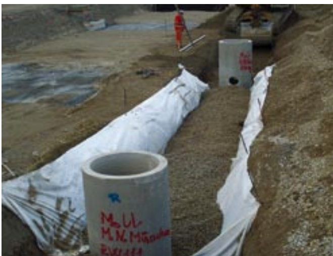
Obr. 64: Podpovrchové vsakování se používá často, protože velmi šetří místo. Oblíbená geotextilie po stranách a na dně vsakovacích drenáží a rýh je ovšem nejen zbytečná, ale dokonce riskantní (viz obr. 65).
