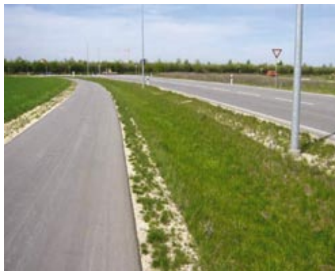
Obr. 76: Vsakování bez povolení na okresních silnicích není vyloučené, pokud, jako zde v Neutrablingu, voda stéká z povrchu přes okraj silnice do mělkého silničního příkopu a v něm pak vsakuje.
