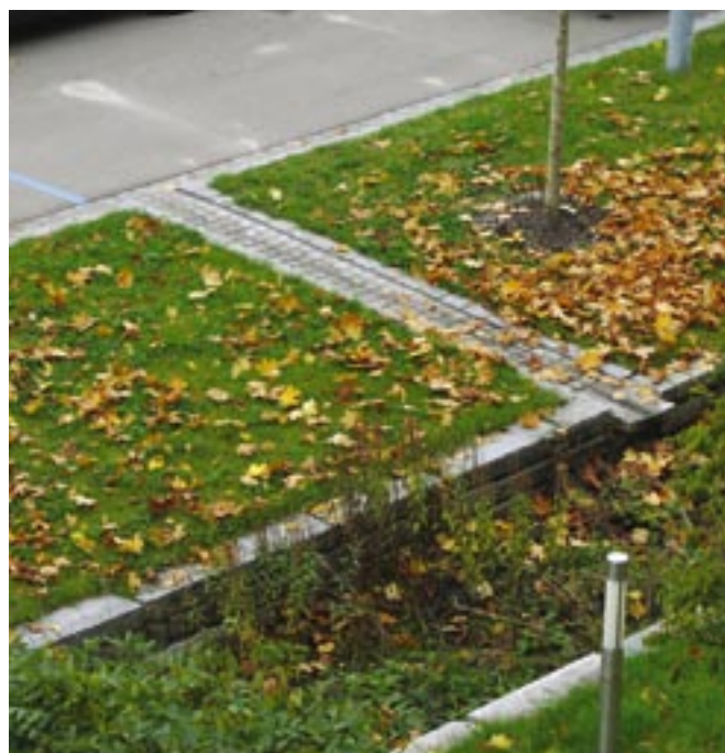
Obr. 82: Dlážděné žlaby svádějí vodu ze silnice do vsakovacích rýh ohrazených nasucho stavěnou zídkaou.
