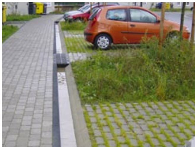
Obr. 66: Prostorově úsporné použití otevřených odvodňovacích žlabů (rigolů) účelně zkombinovaných k vymezení ploch a zároveň přejezdové ochraně mezi parkovacím místem a chodníkem.
