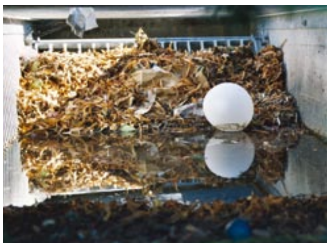
Obr. 56: Vtokové česle před odvodňovacím potrubím jsou nutným a účinným prvkem k zachycování hrubých nečistot odnášených vodou stékající z komunikací a vnějších ploch.
