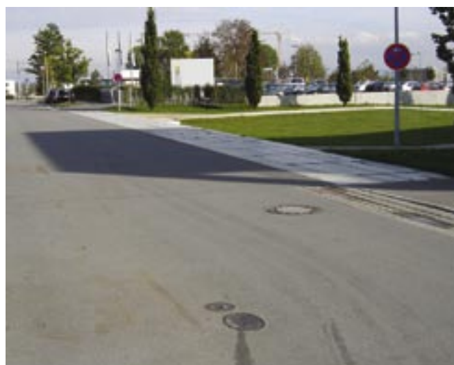
Obr. 90: Šikmý sklon směrem k vsakovací rýze/drenáži – bez povolení, neboť je možný nesbíraný odtok
